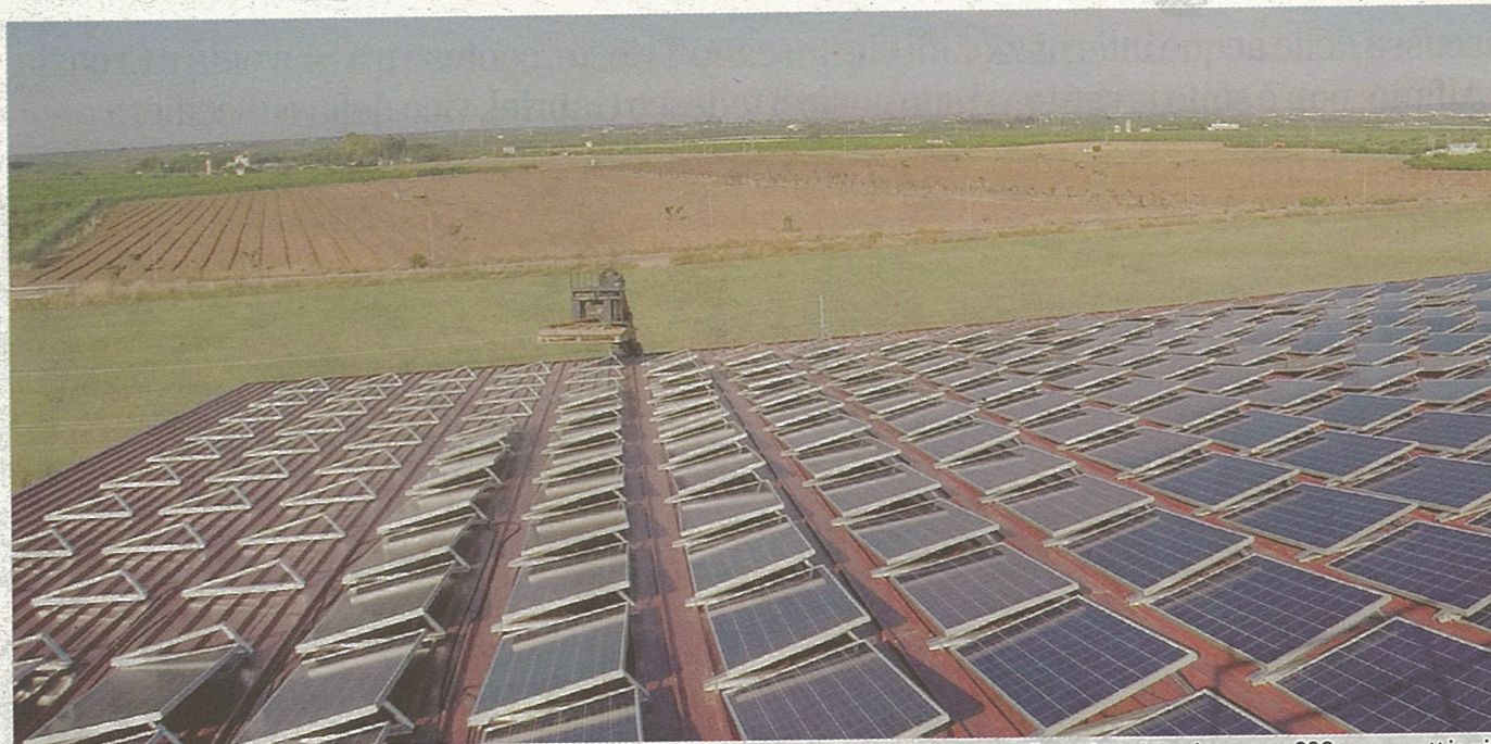
TAVOLIERE Un impianto fotovoltaico di grandi dimensioni in via di installazione nella campagna pugliese. A regime ci saranno 220 megawatt in più
